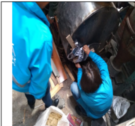
Fotografía No. 1 Imposición de Sellos de la caldera de 30 BHP que opera con retal de madera
