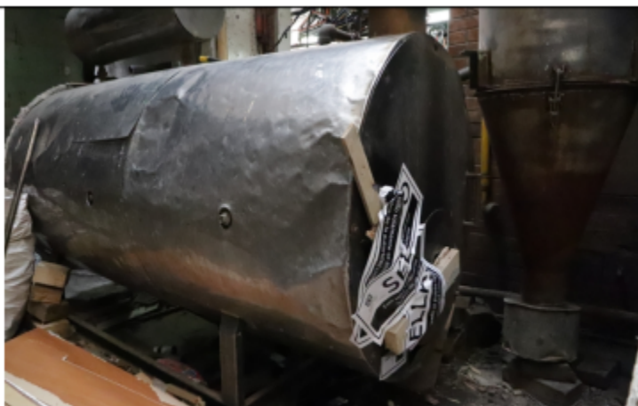
Fotografía No. 3 Caldera de 30 BHP que opera con retal de madera con sellos
