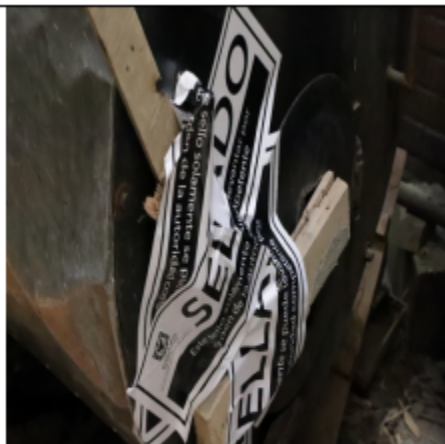
Fotografía No. 2 Imposición de Sellos de la caldera de 30 BHP que opera con retal de madera
